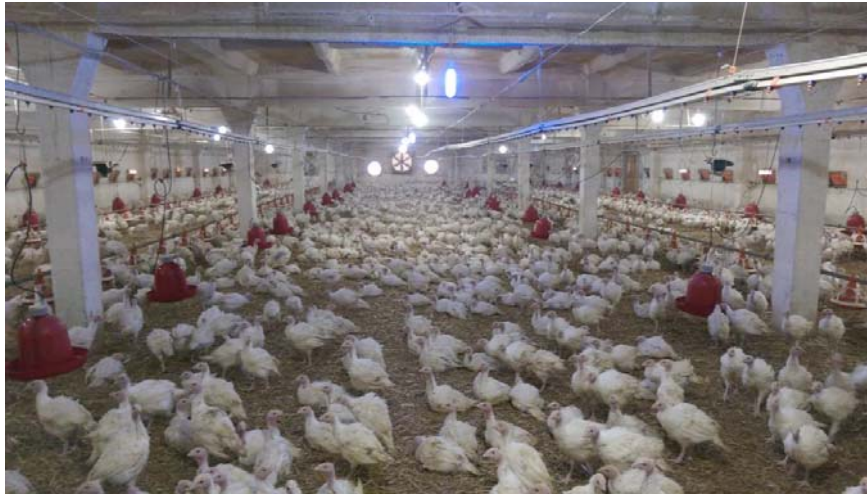
Figura 5.3 Sistemul de ventilație din hala de creștere Figure 5.3 Ventilation system of the breeding shelter
