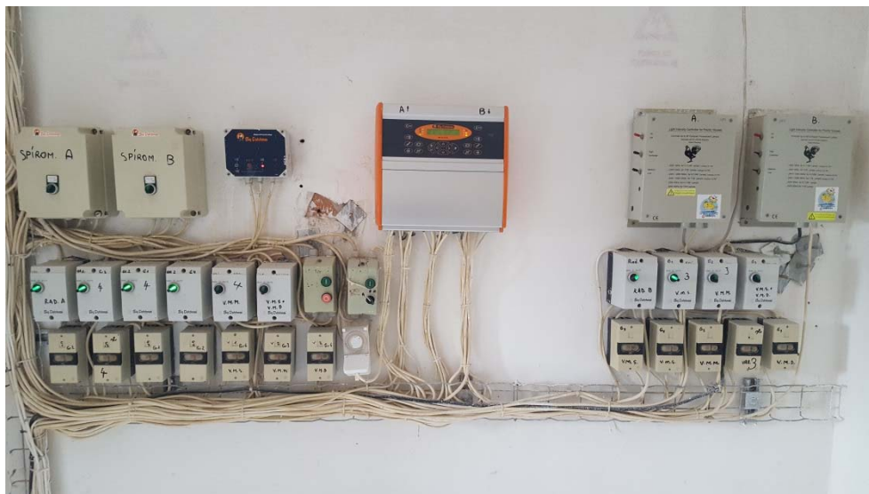
Figura 4.7 Panou de comandă pentru intensitatea luminii Figure 4.7 Control panel for light intensity
