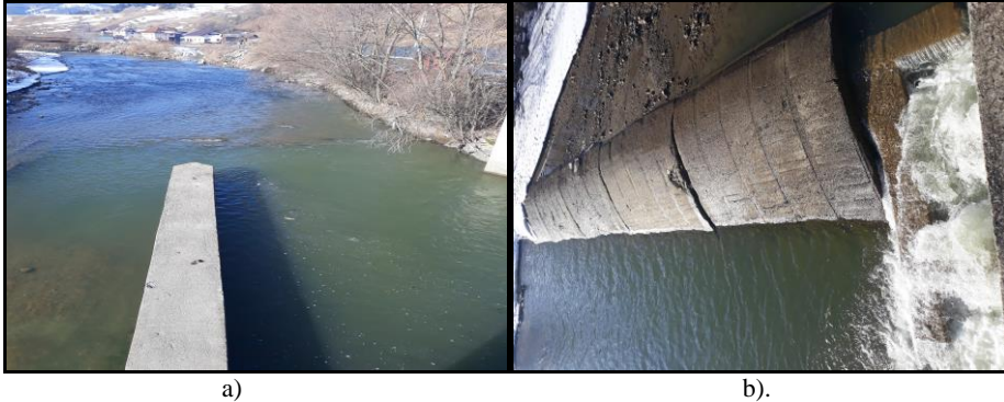
Figura 5.15 Pilă din beton (a) și scara pentru pești (b) CHEMP Pojorâta(original) Figure 5.15 concrete pile (a) and scale for fish (b) SHP Pojorata (original)
