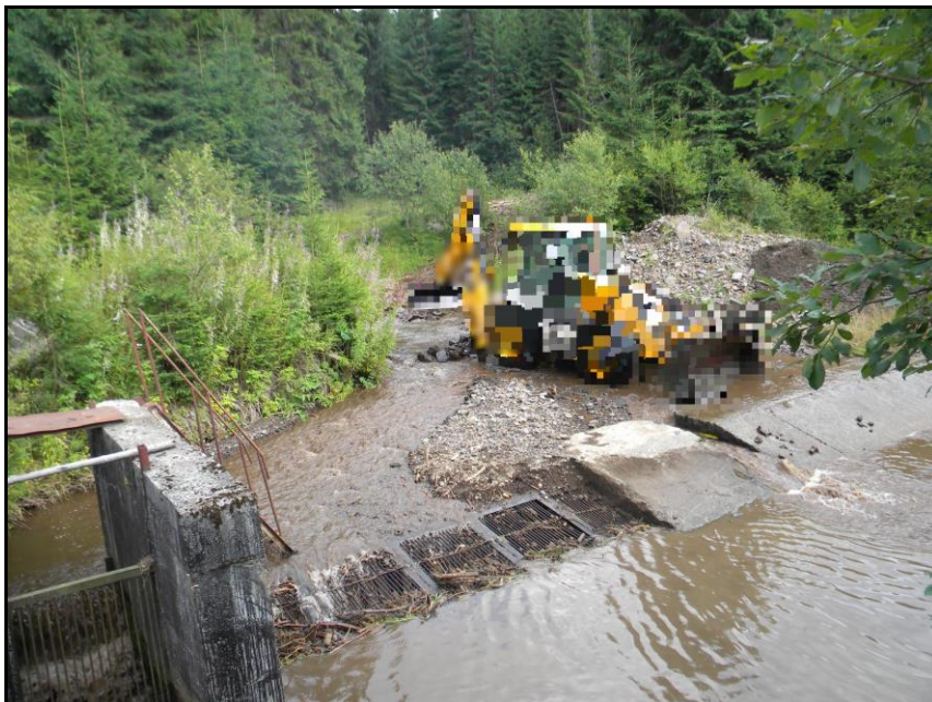
Figura 5.12 Captarea principală a CHEMP amenajată pe pârâul Vorova (original) Figure 5.12 Main capture of CHEMP arranged on the Vorova river (original)
