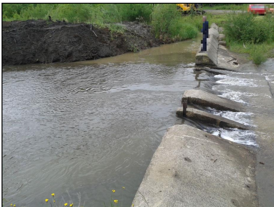
Figura 5.1 Captarea principală a CHEMA Dornișoara, amenajată pe pârâul Dornișoara (Original) Figure 5.1 Main intake of SHP Dornisoara fitting on Dornisoara river (original)
