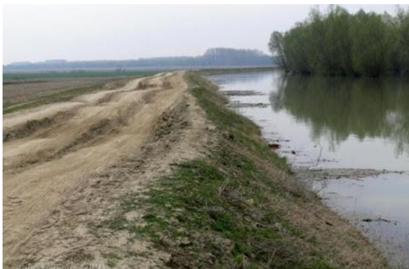
Figura 4.2 Eroziuni în zona dig-mal
