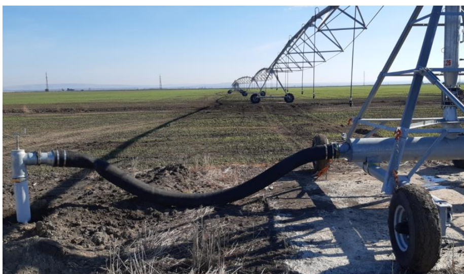
Figura 4.12 Instalație de irigație tip pivot racordat la hidrant
