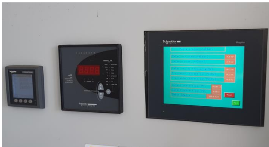
Figura 4.15 Display-ul tabloului de comandă al pompelor Figure 4.15 Pump control panel display
