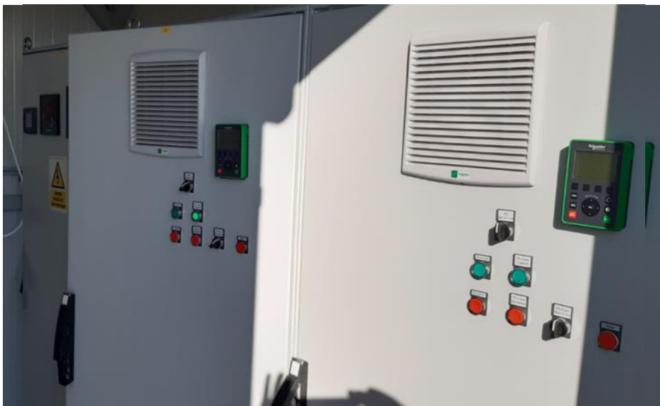
Figura 4.14 Dulap de acționare și comandă a motoarelor pompelor Figure 4.14 Pump motor control and actuation cabinet
