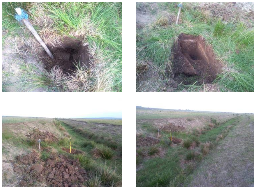
Figura 4.16 - Dren colector colmatat, cu tubul de capăt dislocat (original)
