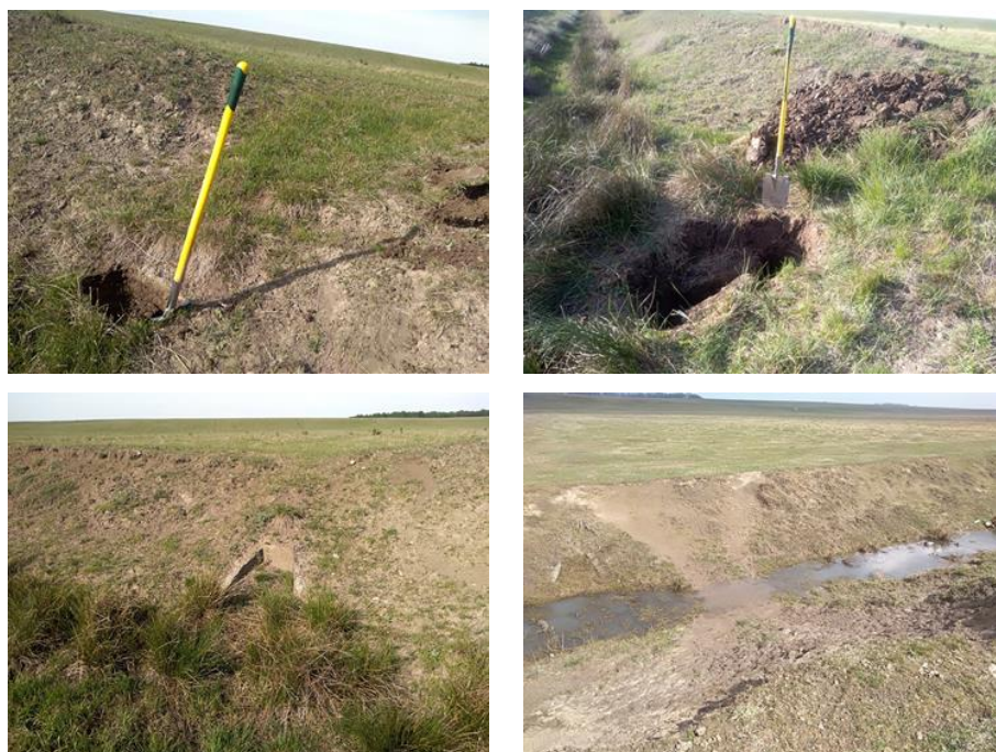
Figura 4.14 - Guri de evacuare colmatate (original)
