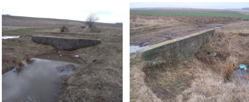
Figura 4.20 - Podețe colmatate (original)
