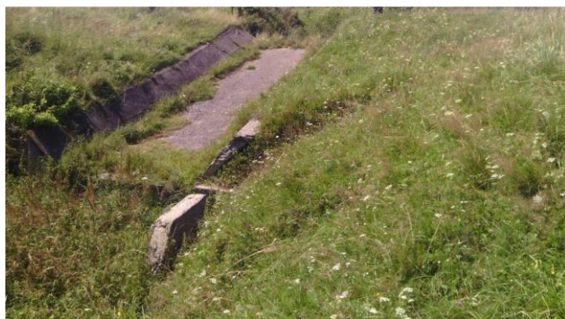
Figura 7.12 Jilip din beton deteriorat în amenajarea C.E.S. Soloneț (original)
