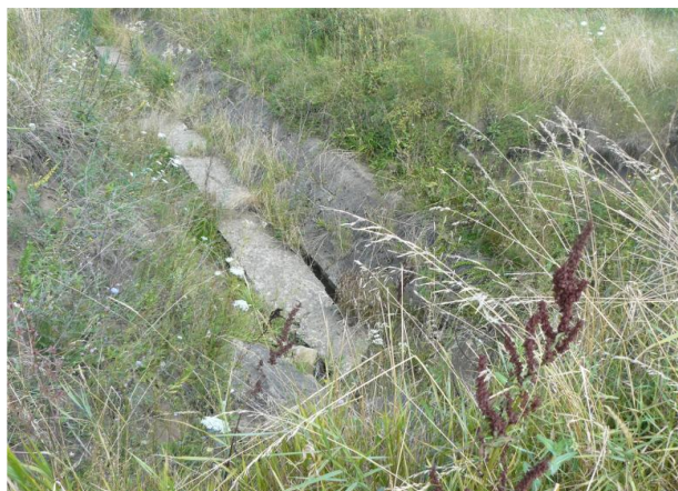
Figura 7.6 Canal de evacuare din beton degradat în amenajarea C.E.S. Ilișasca (original) Figure 7.6 Concrete evacuation channel very degraded in the S.E.C. Ilișasca facility (original)
