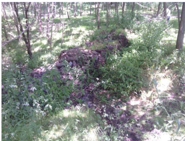
Figura 7.18 Baraj din gabioane deteriorat în amenajarea C.E.S. Ilișasca (original) Figure 7.18 Check dams from gabions damaged in S.E.C. Ilișasca facility (original)
