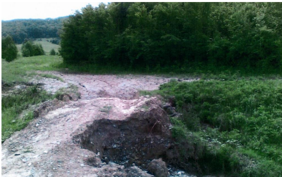
Fig. 4.8 Drum și podet degradat la Antohești Fig. 4.8 Degraded road and bridge at Antohești
