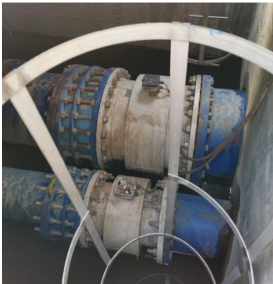
Figura 5.11. Apometre pe fiecare treaptă de pompare Figure 5.11. Water meters on each pumping stage
