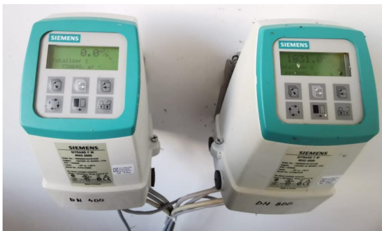
Figura 5.18. Dispozitiv pentru contorizarea numărului de ore de funcționare al pompelor
