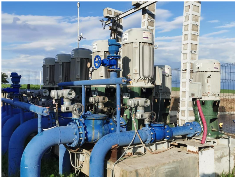
Figura 5.4. Electropompele Stației SPP1b
