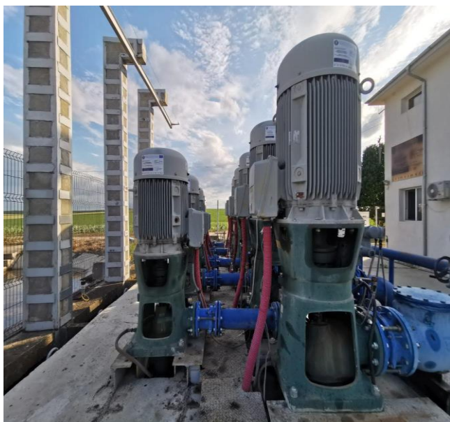
Figura 5.5. Electropompe pentru cele două trepte de pompare Figure 5.5. The electric pumps for the two pumping stages
