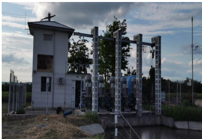
Figura 4.1. Stația de pompare și punere sub presiune SPP 1.b Figure 4.1. Pumping and pressurizing station SPP 1.b
