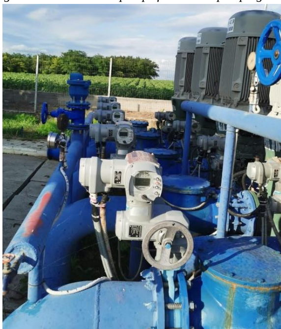
Figura 5.6. Armături, tubulatură, robinete, apometre Figure 5.6. Fittings, piping, taps, water meters
