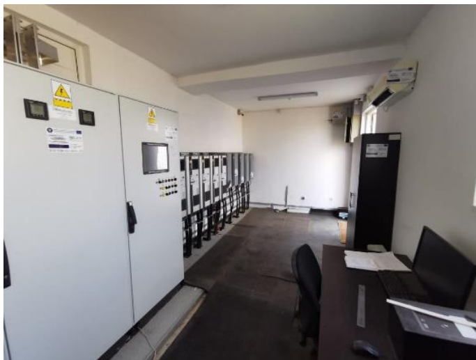
Figura 5.9. Camera de control și monitorizare a Stației SPP1b Figure 5.9. The control and monitoring room of the SPP1b station
