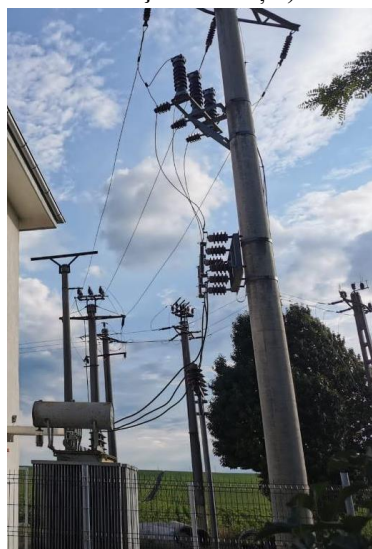
Figura 5.8. Rețeaua electrică a stației SPP1b după reabilitare
