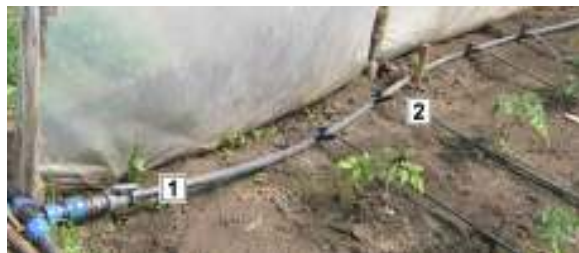
Fig.4.8. Conducta secundară de distribuire a apei ( poză originală ): 1- țevă secundară de distribuire a apei; 2 - bandă de udare cu picurătoare. Fig.4.8. Secondary water distribution pipeline ( original photo ) 1- secondary water distribution pipe; 2 - dripping band.
