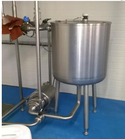
Figura 5.17 Instalație de curățire CIP(original)
